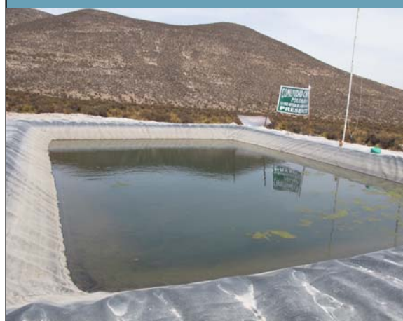
Vista del reservorio instalado con el revestimiento de la geo membrana con capacidad de 250 m 3 de agua.
